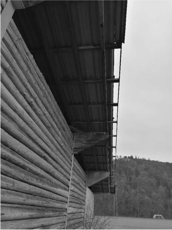
Schaden Dach Schnitzelhalle
